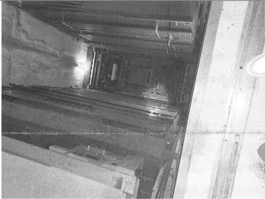
說 明 一 事發飯店之機械式停車設備現場俯視照片。(罹災者倒臥於圖中底部升降平台下方機坑)
