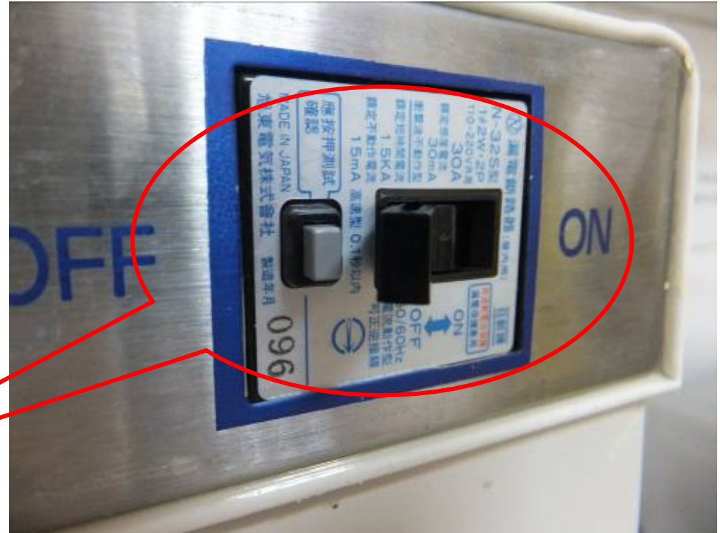
茶水間蒸飯機 漏電斷路器
